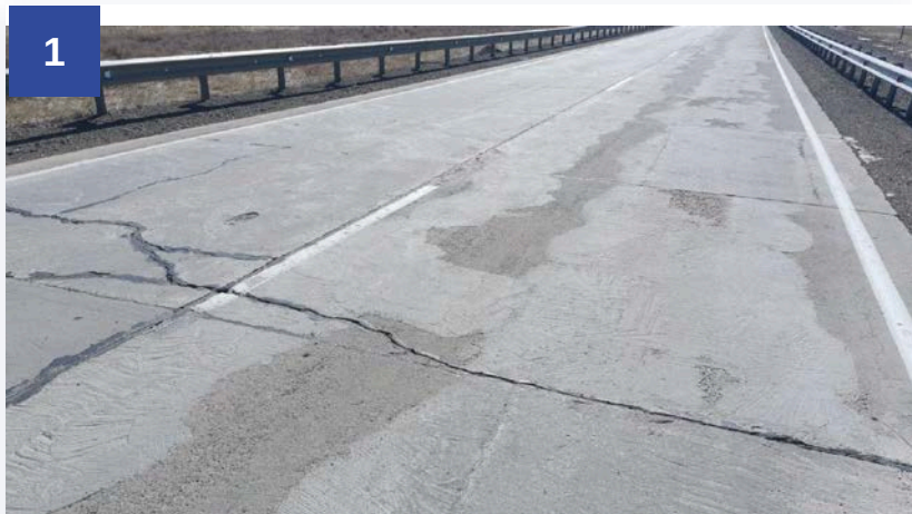
Выкрашивание и шелушение покрытия
