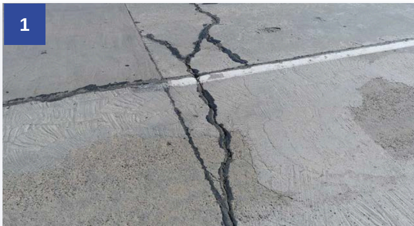
Трещина в покрытии на сопряжении с мостом
