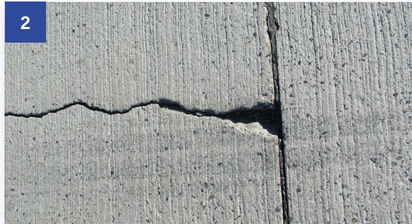
Редкие поперечные трещины
