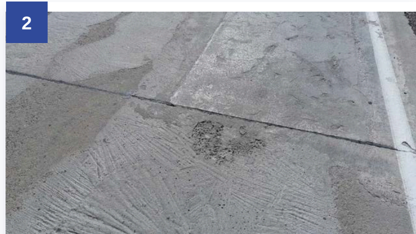
Выкрашивание и шелушение покрытия
