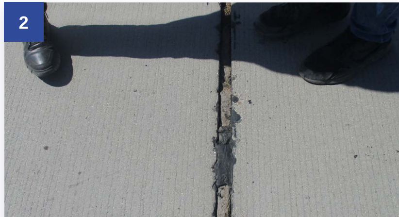
Повреждение заполнения шва
