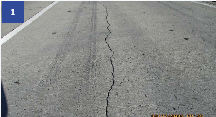
Единичные продольные трещины
