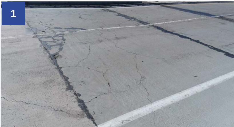
Сетка трещин в покрытии
