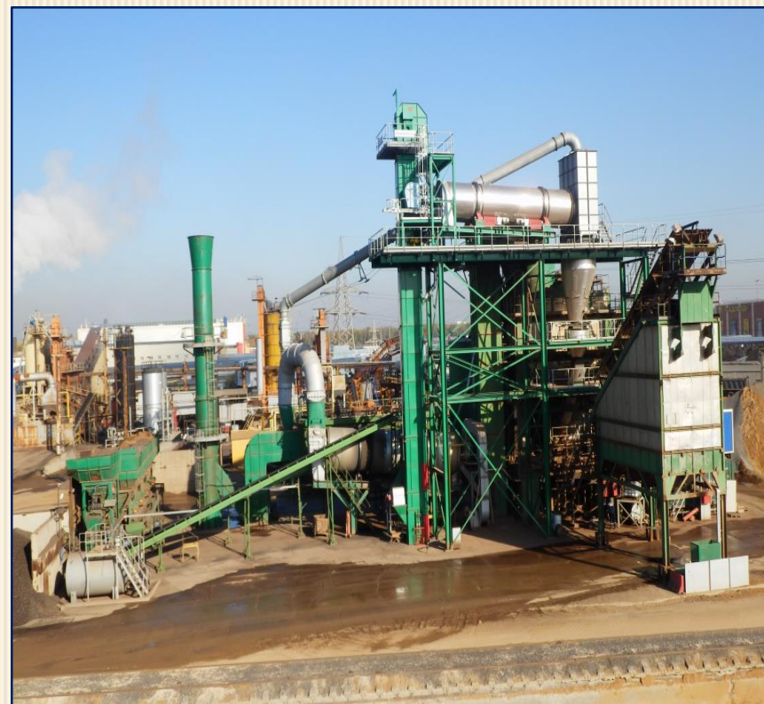
Установка с дополнительным барабаном на АБЗ «Капотня»
