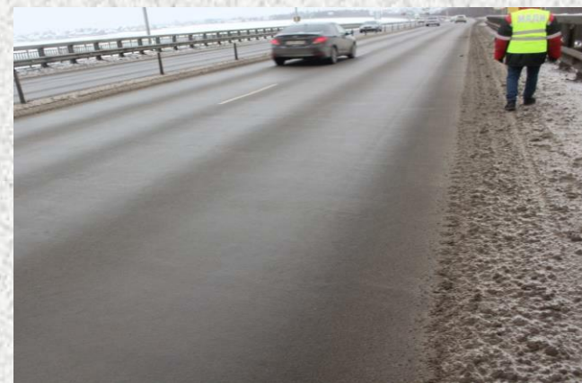
Состояние тонкослойного покрытия на п/ч из полимербетона при ремонте (2018 г.)
