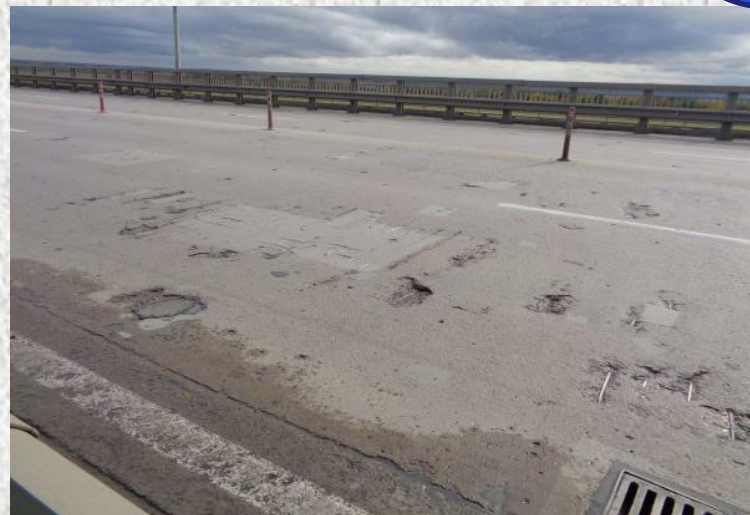
Локальные разрушения п/ч из ц/б
