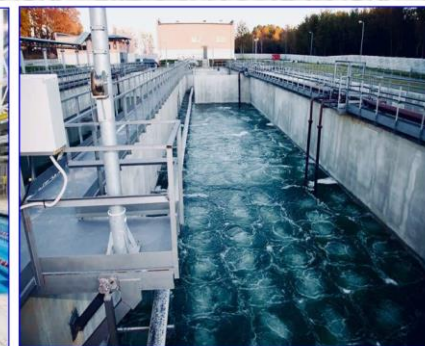
Резервуары с питьевой водой
