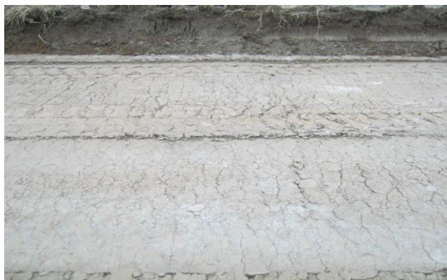
Усадочные трещины на основании
