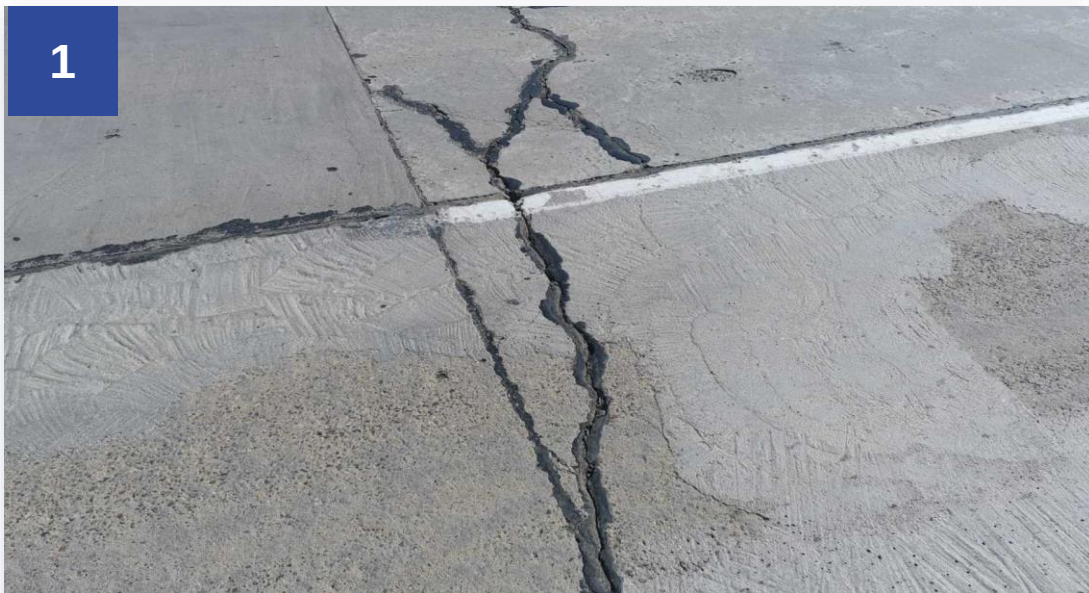
Трещина в покрытии на сопряжении с мостом
