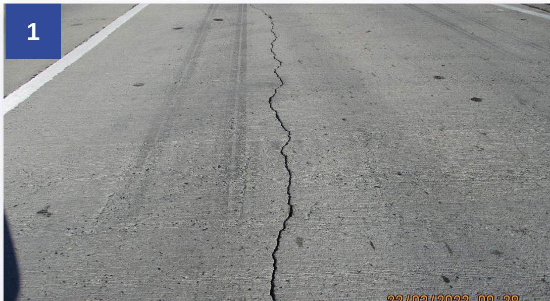
Единичные продольные трещины
