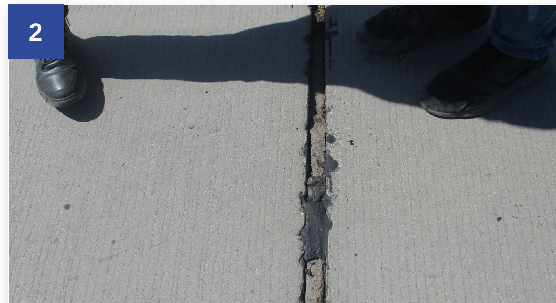
Повреждение заполнения шва
