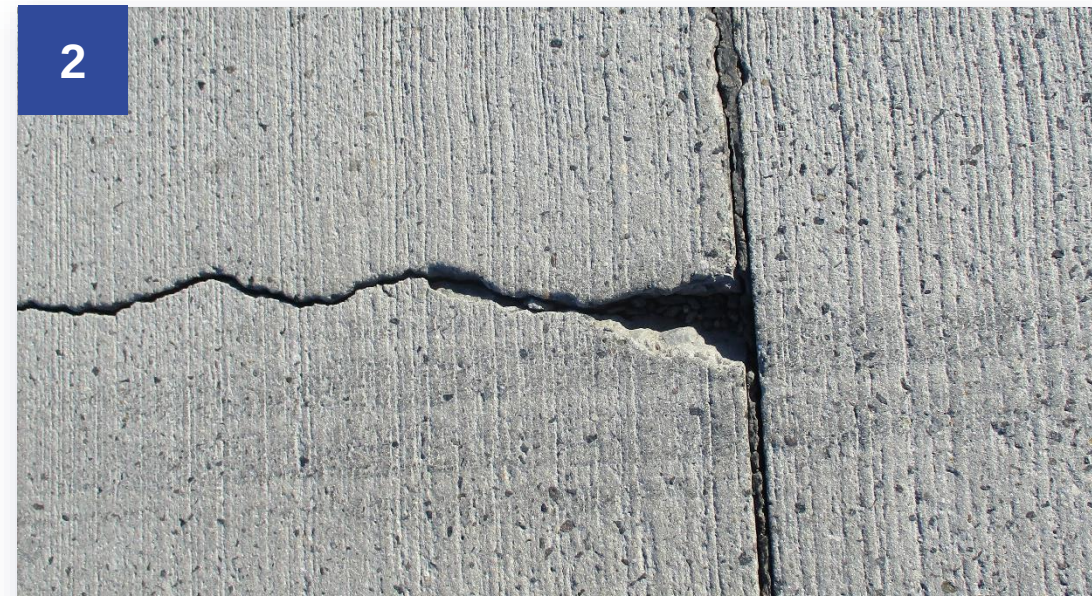
Редкие поперечные трещины
