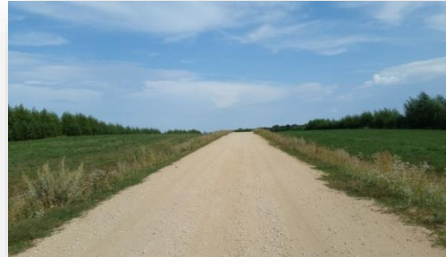
Состояние участков автомобильной дороги (после года эксплуатации)
