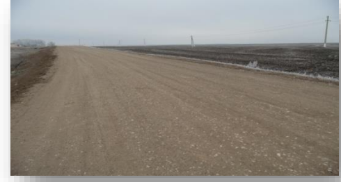
Состояние участков автомобильной дороги (после двух лет эксплуатации)
