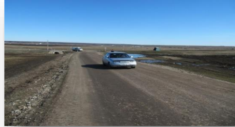
Состояние участков автомобильной дороги (после года эксплуатации)
