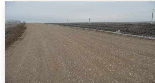
Состояние участков автомобильной дороги (после двух лет эксплуатации)
