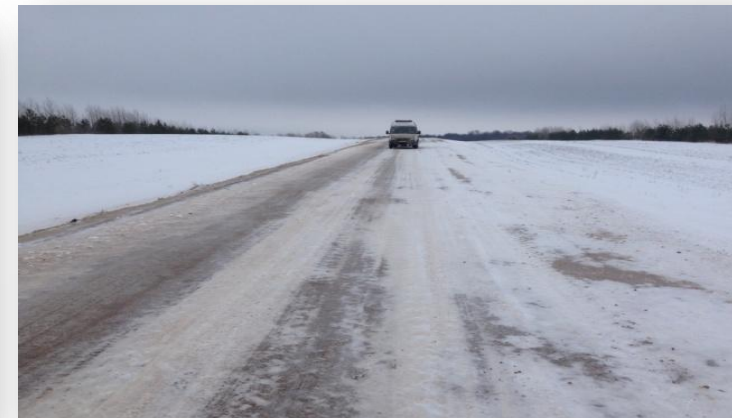
Состояние участков автомобильной дороги (после двух лет эксплуатации)
