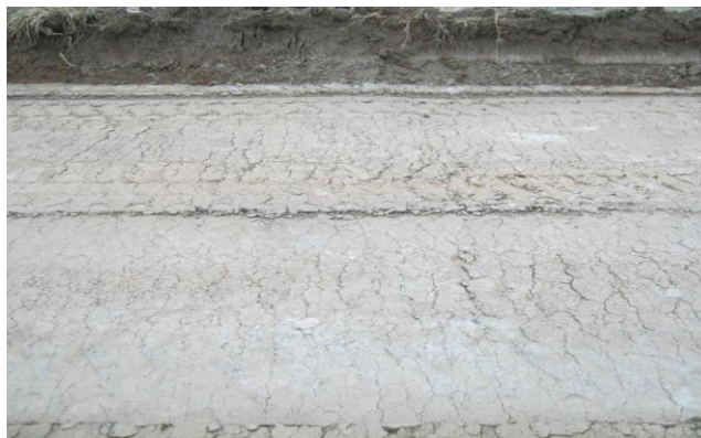
Усадочные трещины на основании
