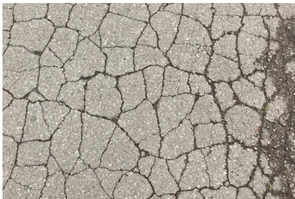
б) Усталостное разрушение
