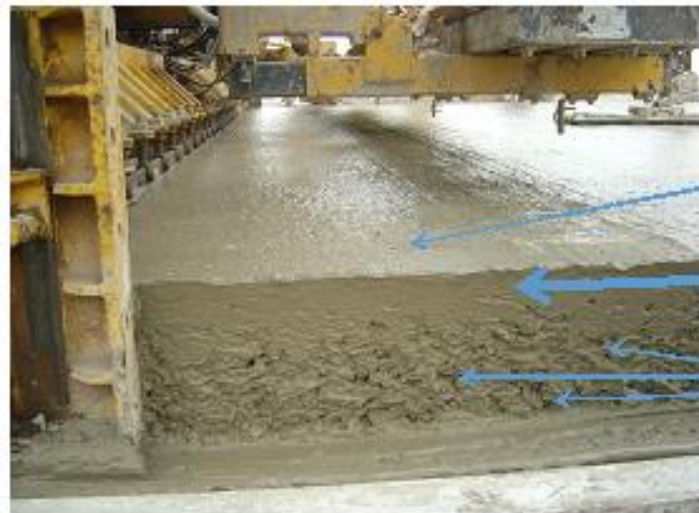
Проблемы при укладке бетонной смеси
