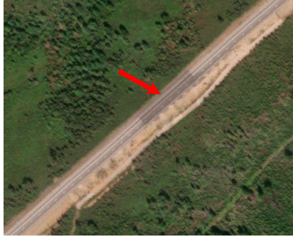
Следы ремонта на участках тепловой осадки насыпи
