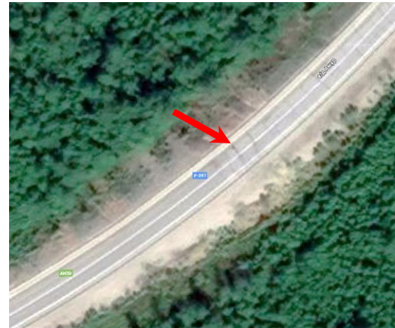
Сгущение трещин на дорожном полотне, свидетельствующее о деформациях насыпи
