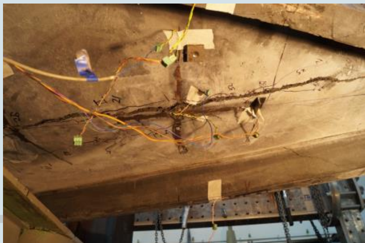
Распределение трещин в нижней части плиты
