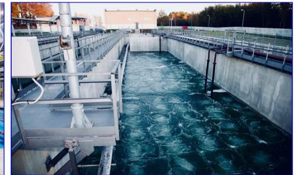
Резервуары с питьевой водой
