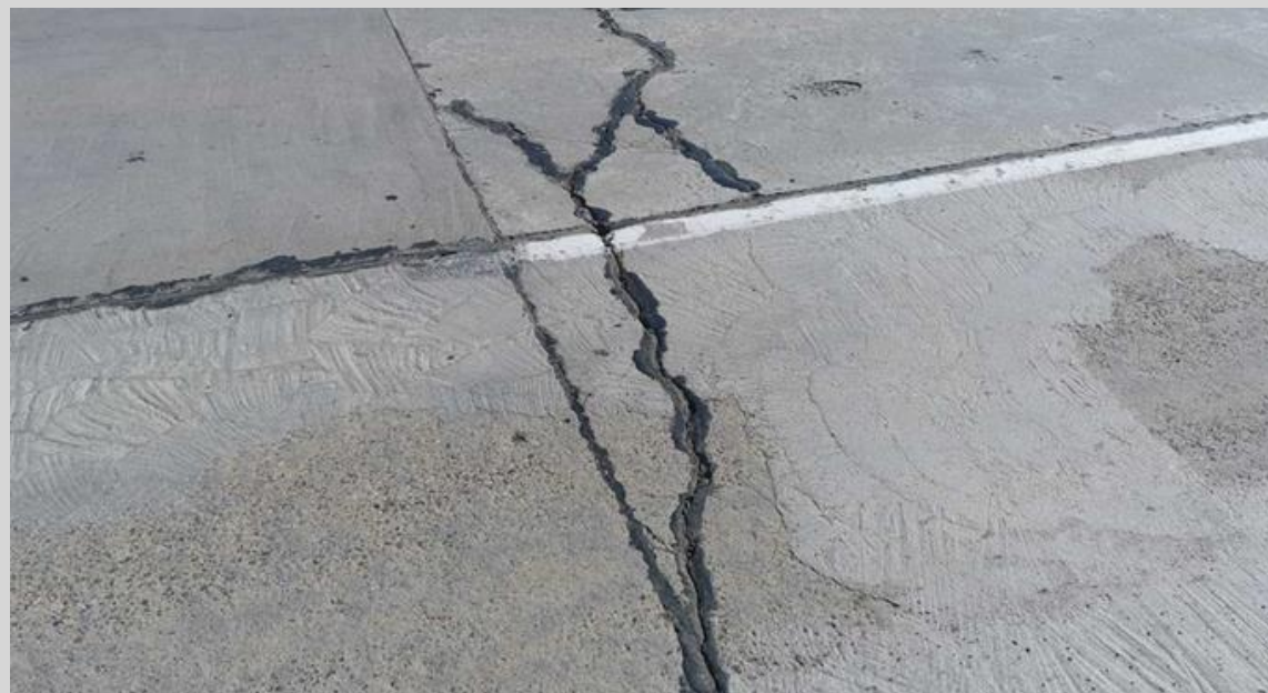
Трещина в покрытии на сопряжении с мостом
