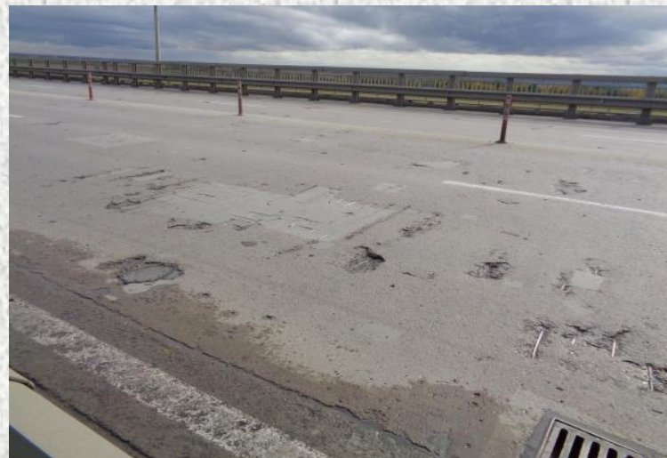
Локальные разрушения п/ч из ц/б
