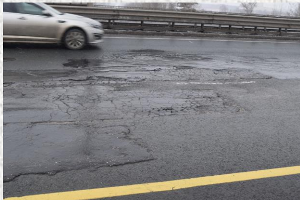
Фото 4. Разрушение покрытия по полосам наката
