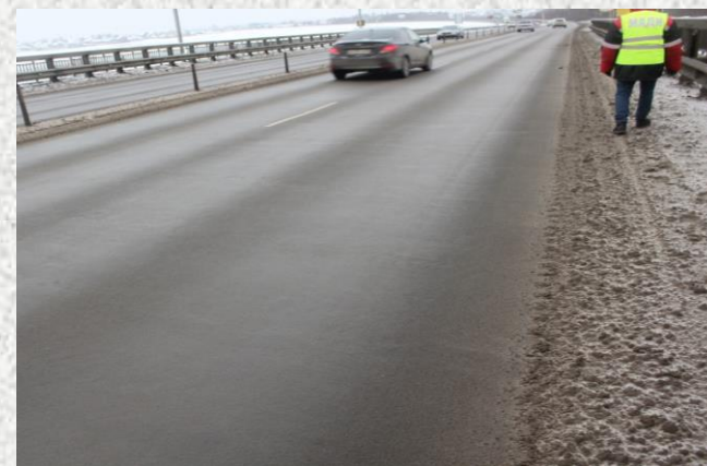
Состояние тонкослойного покрытия на п/ч из ц/б при ремонте (2018 г.)
